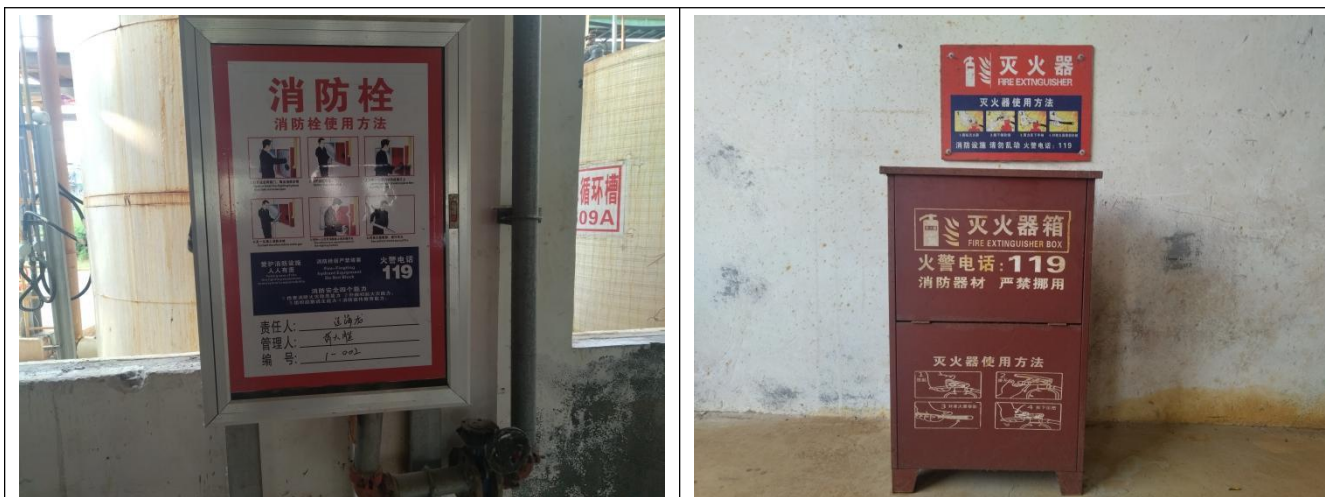
车间消防栓和灭火器
