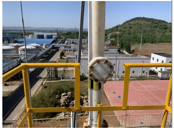
废气排气筒监测口↑
